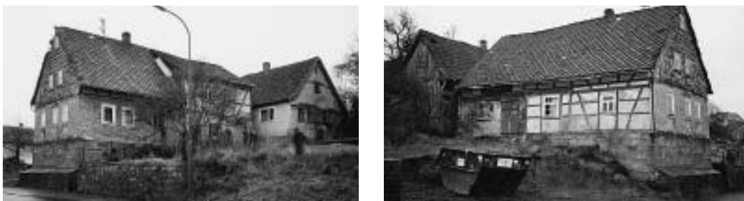
Abb. 11, 12: Eine typische Hofanlage in Sandberg im Jahr 1998: Die Gebäude stehen leer und zeigen starke Schäden. 9
